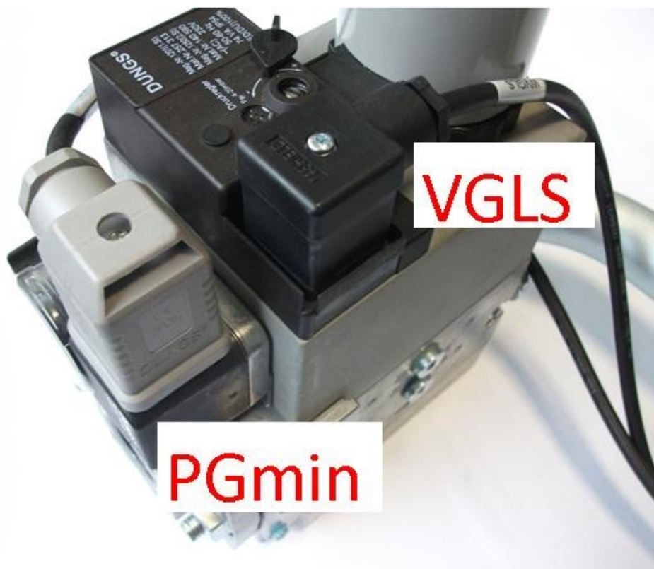
Connessione elettrica rampa gas/Electrical connections to the gas train/Conexiones eléctricas del rampa de gas
